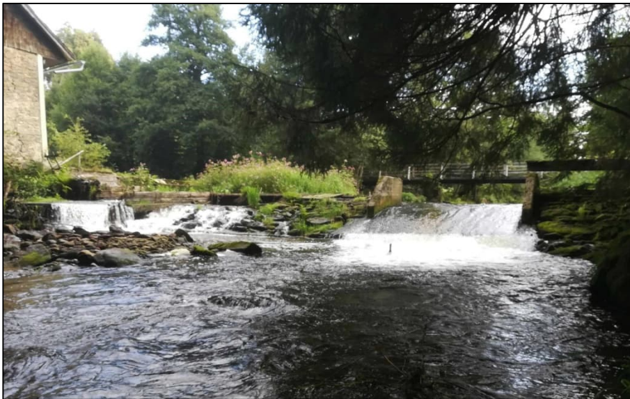
Rothbach bei Böbrachmühle. Wehranlage nicht durchgängig.
