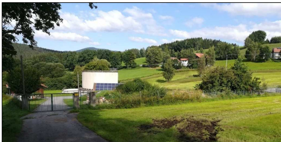
Kläranlage bei Roppendorf
